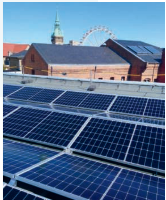
PV-Anlage Gymnasium Kleine Burg, Braunschweig.
