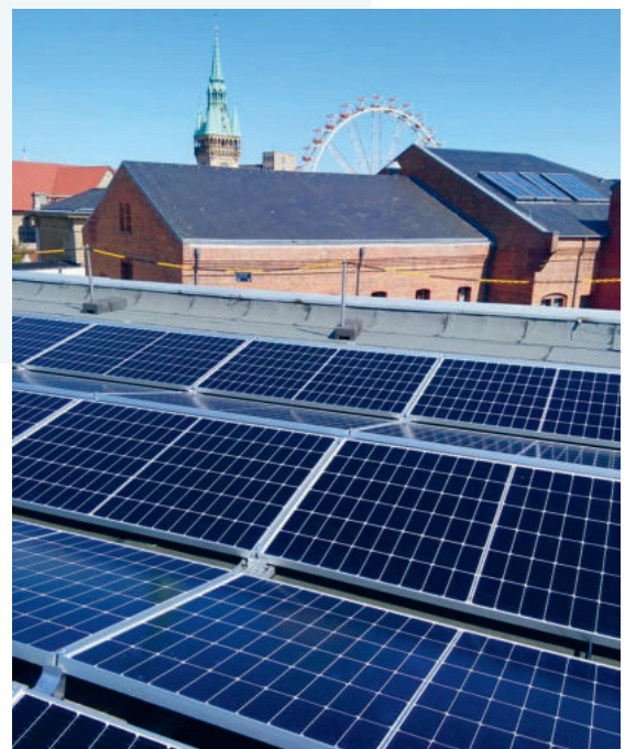
PV-Anlage Gymnasium Kleine Burg, Braunschweig.
